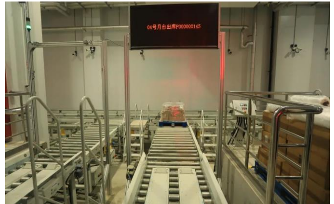
图 35：万纬自动化立体库内设施
